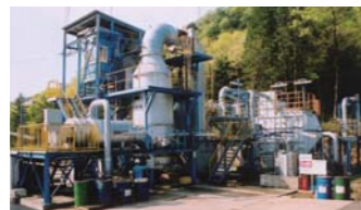
回収インフレーター作業処理設備
